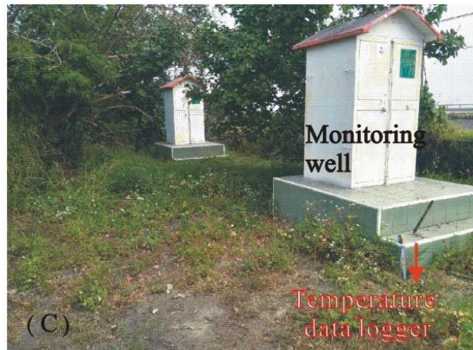
圖 4 (A)編號 28 號井在 google 衛星影像上的位置，(B)基於衛星影像以人工判別土地利用狀況，(C)現場之照片，顯示觀測井的儀器箱及基礎台，溫度計埋設之位置(紅色箭頭)。
