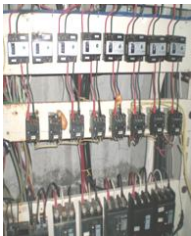
圖一、溫泉 SPA 用泵之配電箱
