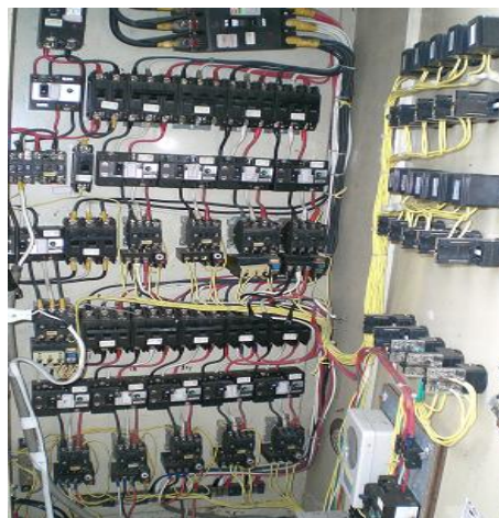
圖二、冷水機用之電源配電箱
