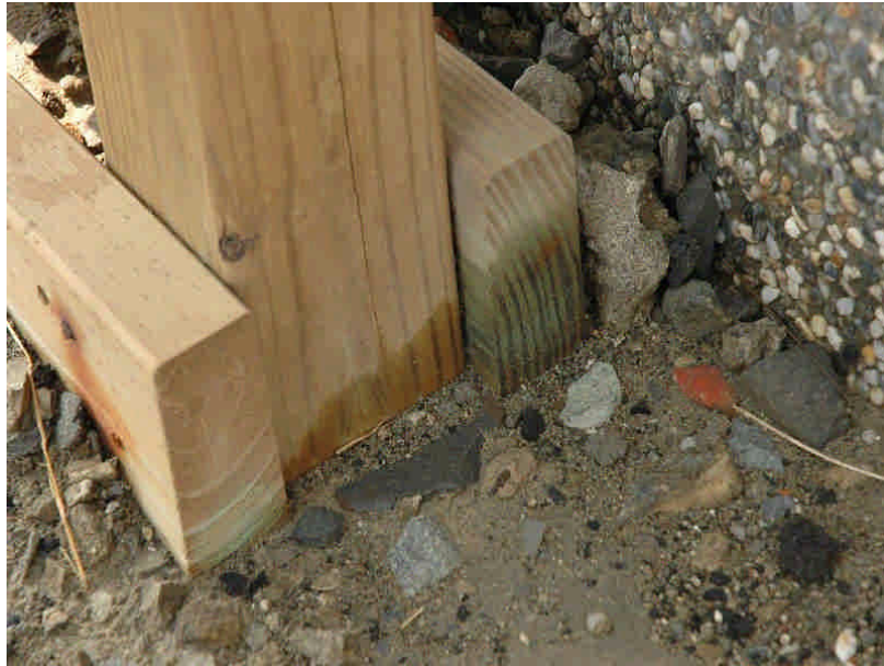
圖 3. 木柱直接與地面接觸，產生局部滯水的現象。
